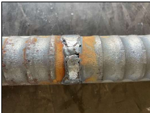
写真-3. 2 溶け込み不足
